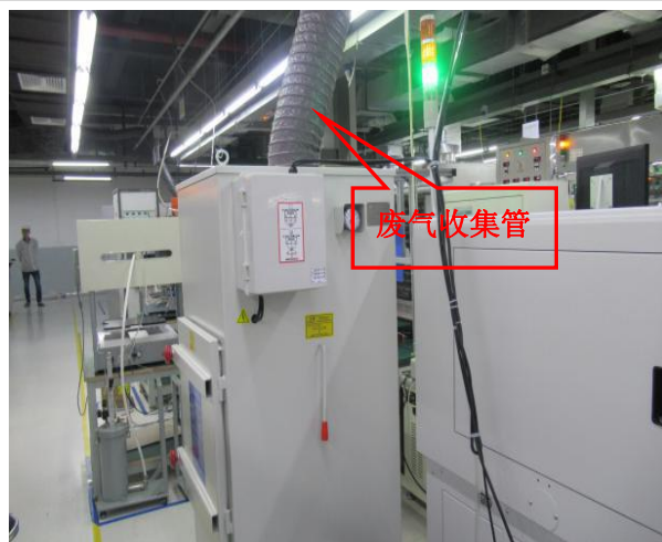
维修焊废气收集装置
