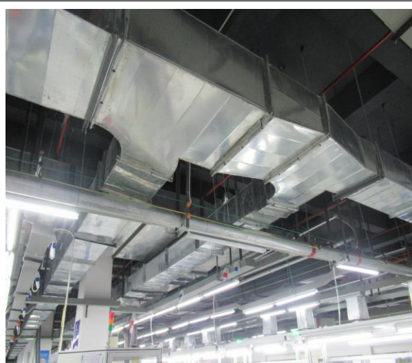
车间废气收集管道
