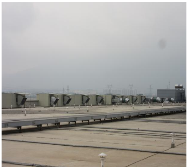
车间通风换气装置
