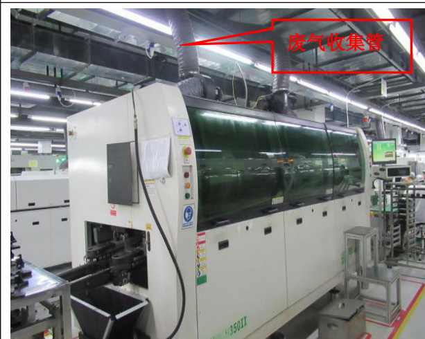
波峰焊废气收集装置
