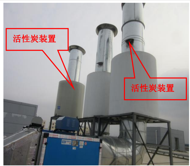
活性炭装置及监测采样口
