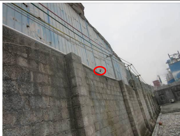
围墙喷淋设施
