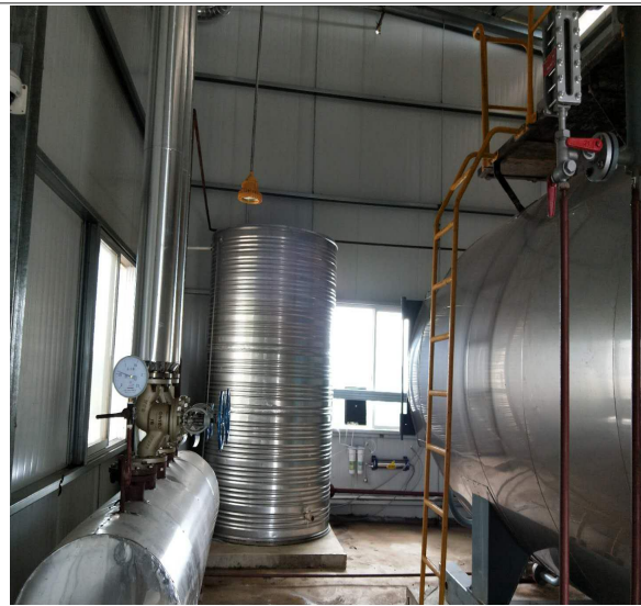
天然气锅炉房
