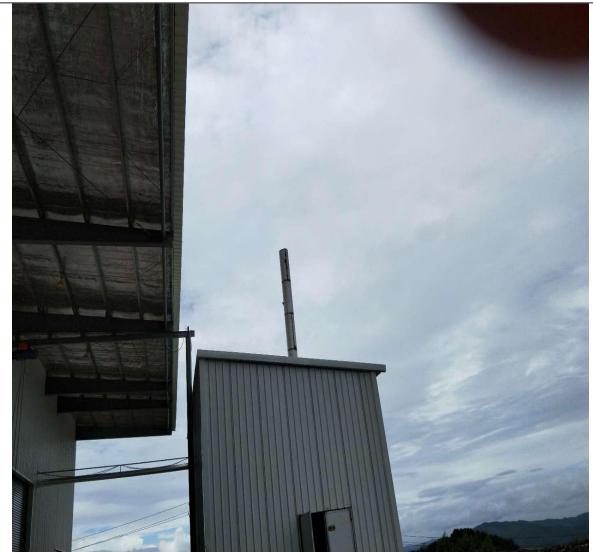
天然气锅炉排气筒
