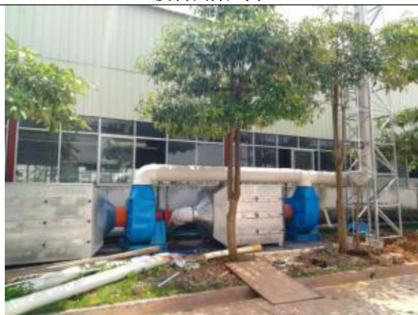
处理热熔废气活性炭装置
