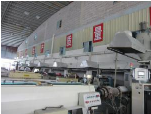
管材、管件生产线塑化挤出机上方的集气罩
