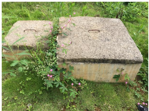
污水处理站总排口
