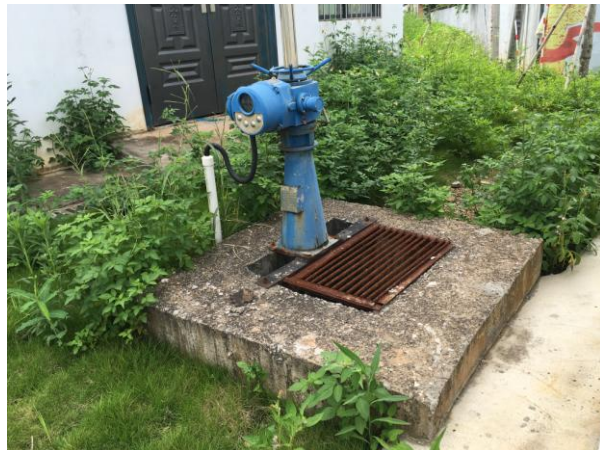
污水处理站总入口
