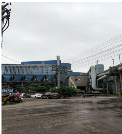
炼钢转炉除尘器
