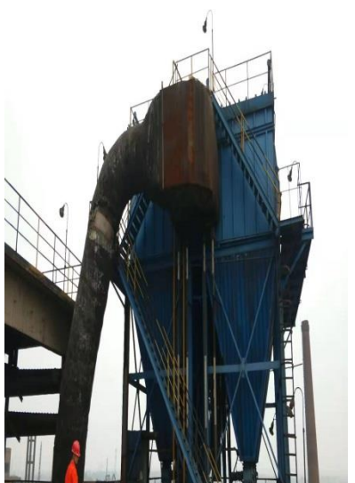
1080m3 高炉制粉除尘器
