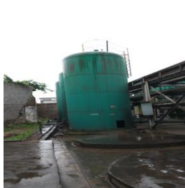
废水处理设施（过滤器）
