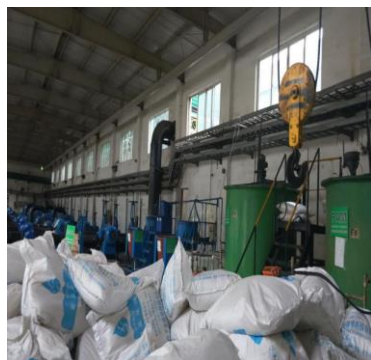
废水处理设施（加药间）
