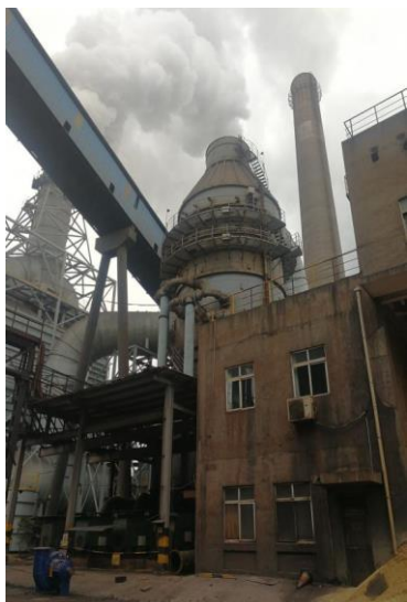
烧结机头烟气脱硫塔
