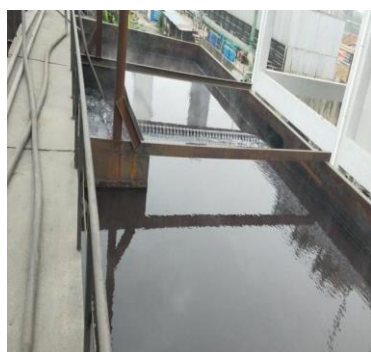
废水处理设施（沉淀回用池）
