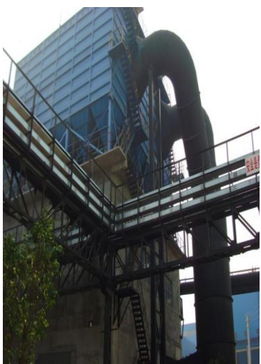
炼铁 1080m 3 高炉出铁口除尘器
