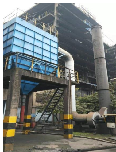
1080m3 高炉破煤除尘器
