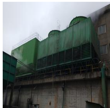
废水处理设施（冷却塔）
