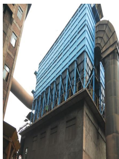
1080m 3 高炉矿槽除尘器
