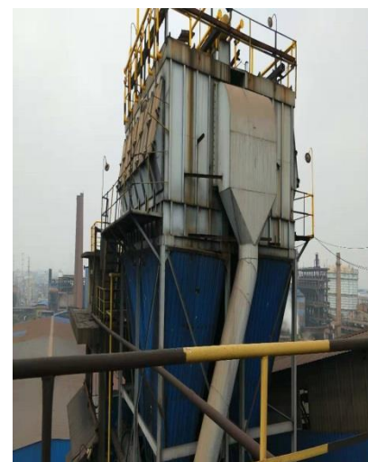
530m 3 高炉制粉除尘器
