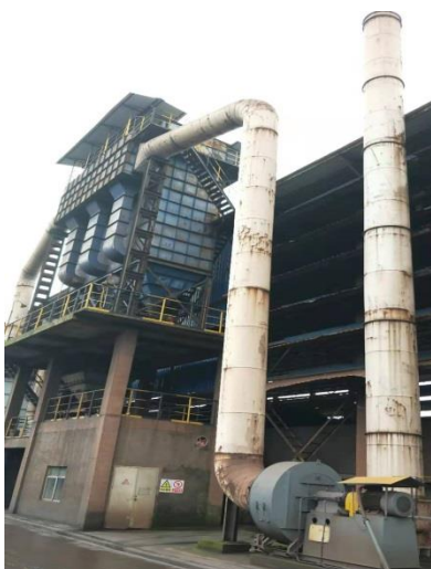
530m 3 高炉破煤除尘器
