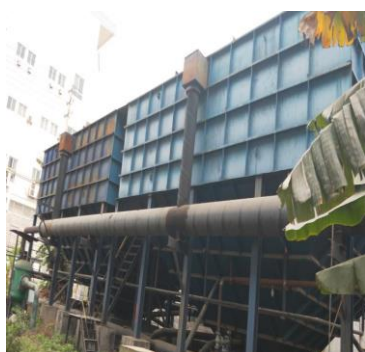
废水处理设施（沉淀池）
