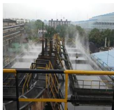
废水处理设施（斜板沉淀池）
