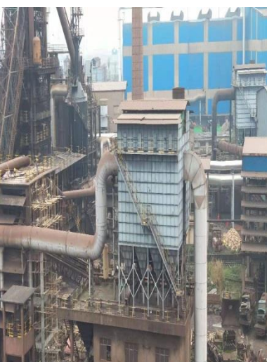
530m 3 高炉矿槽除尘器
