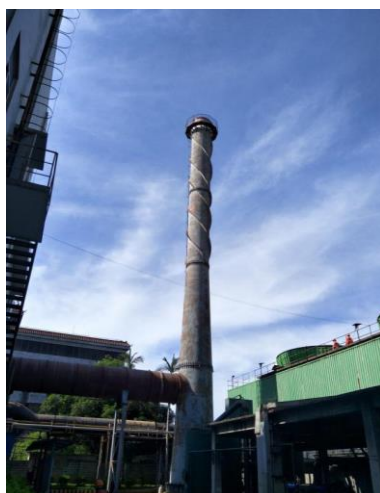
电厂燃气锅炉废气排放烟囱
