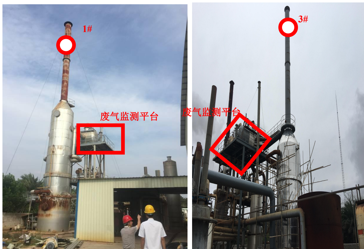
图 4-1 废气排放口及监测平台
