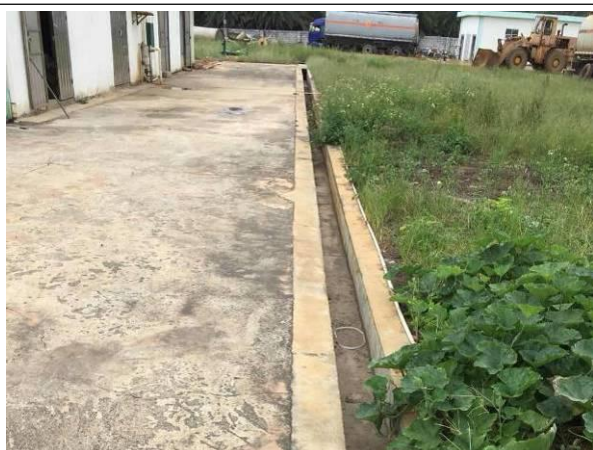
厂区雨水管网
