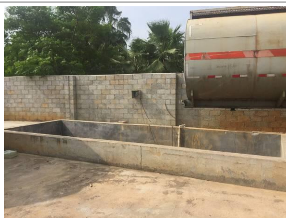
厂区初期雨水收集池
