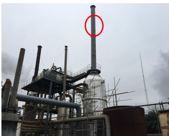
3#尾气锅炉（本次验收）
