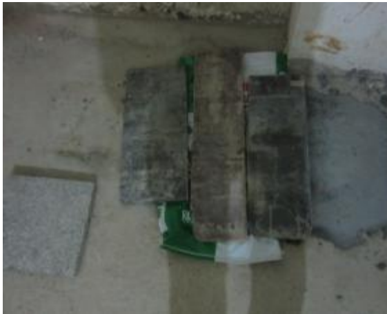
地埋式生化污水处理系统消毒池出水口
