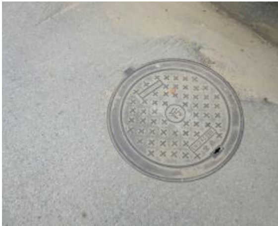
市政污水管网
