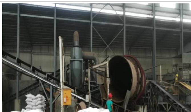
冷却工序及旋风除尘
