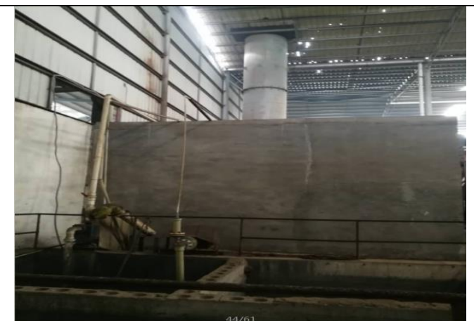
原有项目废气处理设施
