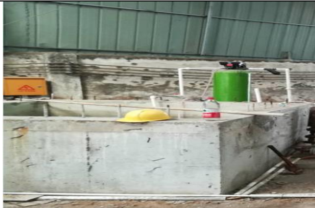
锅炉用软水制备设施
