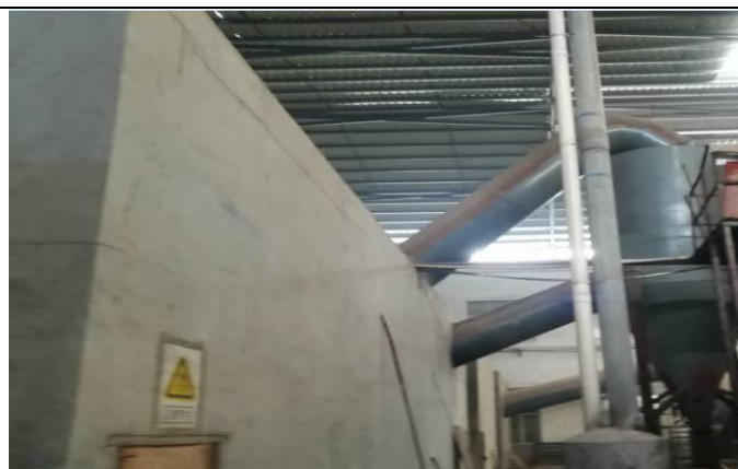
四沉降除尘及水雾除尘
