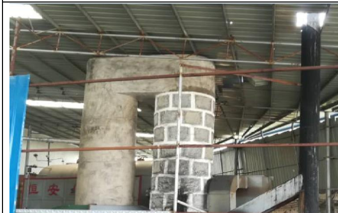
生物质锅炉烟气麻石水膜处理设施
