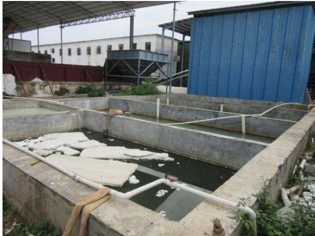
二次水洗沉淀池
