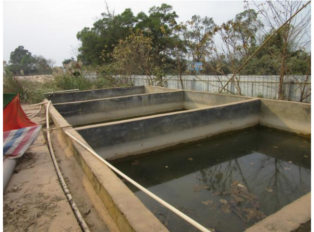
一次水洗废水沉淀池、雨水收集池
