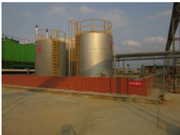
柴油、液碱、氨水储罐区及围堰、喷淋管
