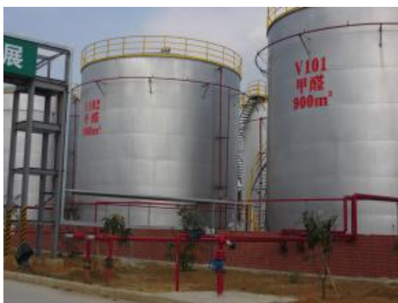
甲醛储罐区及围堰、喷淋管
