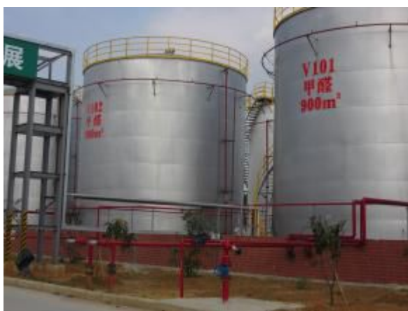
甲醛储罐区及围堰、喷淋管
