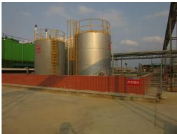
柴油、液碱、氨水储罐区及围堰、喷淋管
