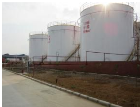
甲醇储罐区及围堰、喷淋管
