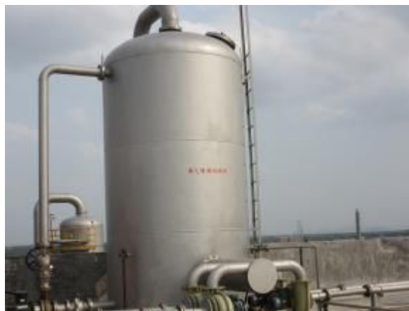
胶水废气喷淋装置
