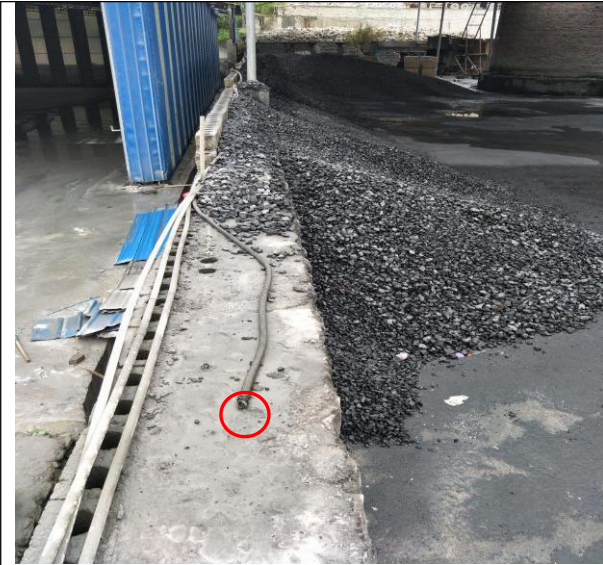
厂区喷淋设施
