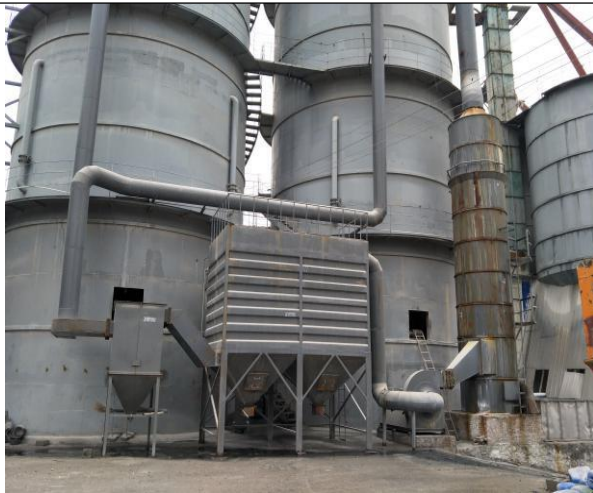
布袋除尘+脱硫除尘系统
