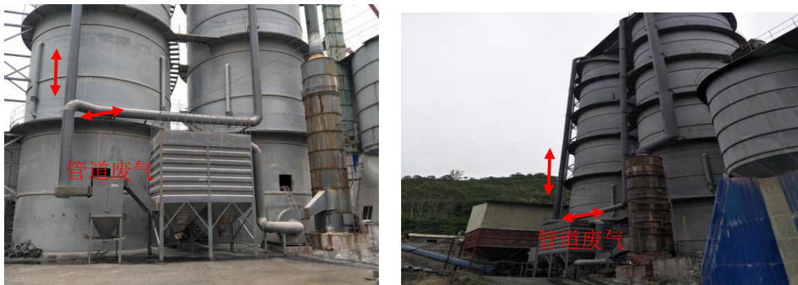
图 6-1 项目布袋除尘+脱硫除尘系统的多个管道进口示意图
