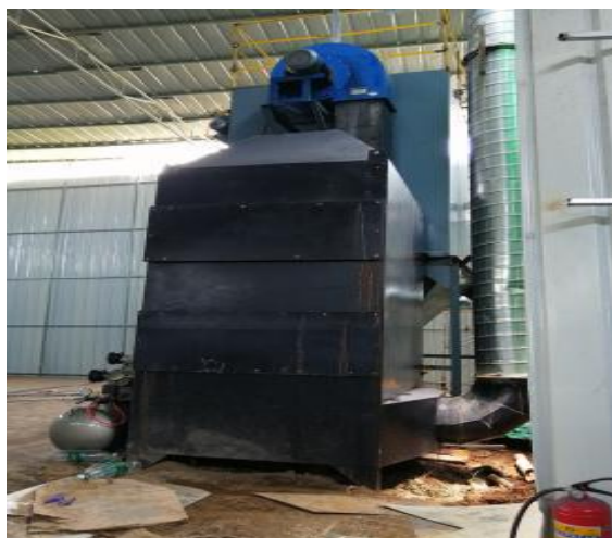
布袋除尘器+活性炭吸附装置
