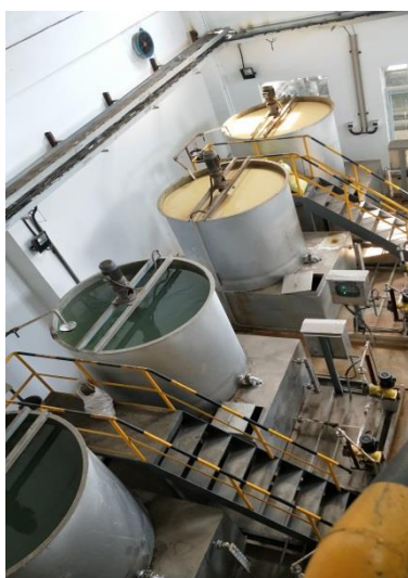
废水处理设施 5
