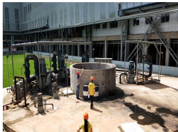
废水处理设施 4
