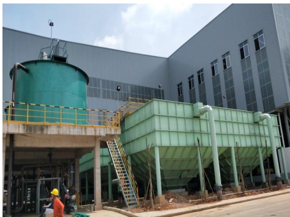
废水处理设施 1
