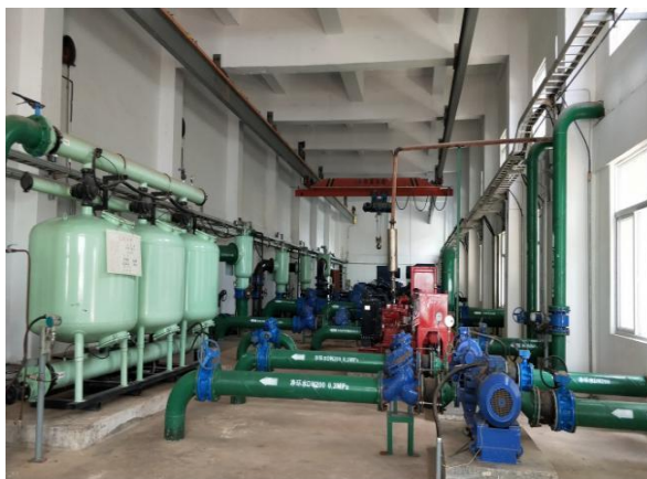
废水处理设施 3
