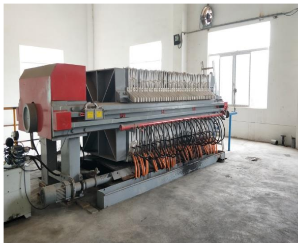
固废处理设施 3
