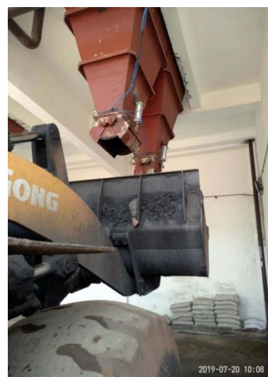
固废处理设施 1
