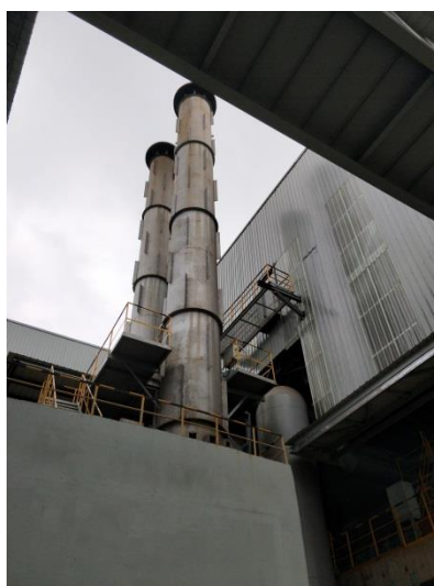
废气处理设施
