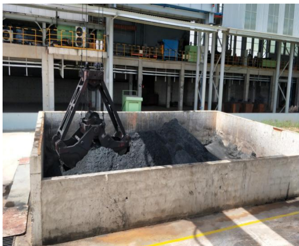
固废处理设施 2
