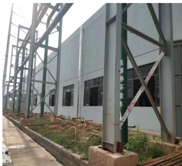
密闭的循环水泵房
