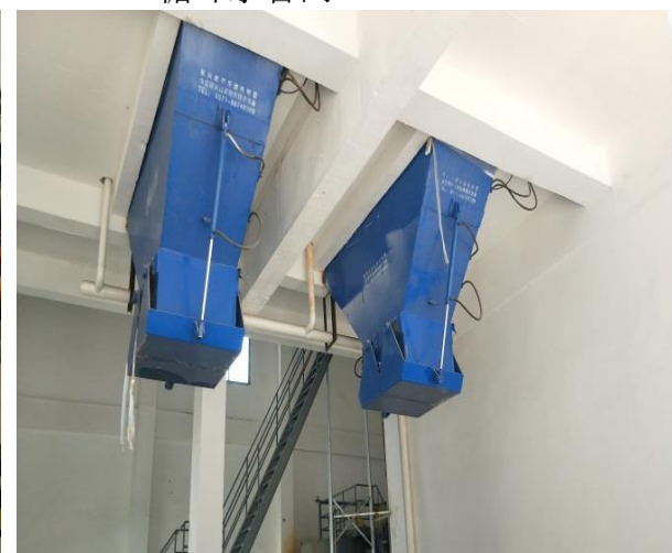
板框压滤机卸污泥口
