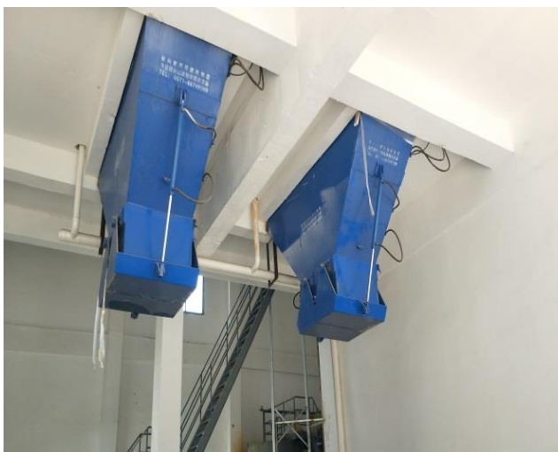
板框压滤机卸污泥口
