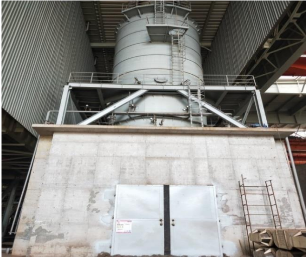
急冷塔+沉降室
