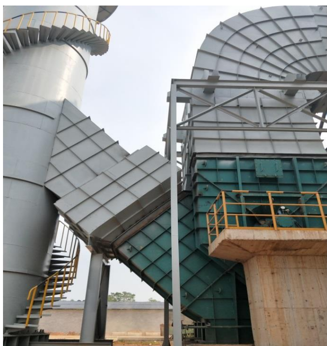
除尘器风机消声器
