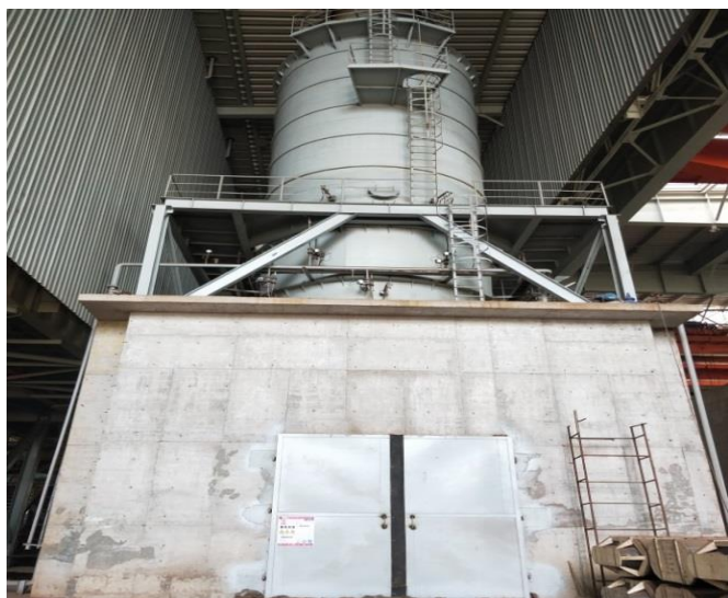
急冷塔+沉降室
