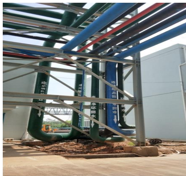
循环水管网二
