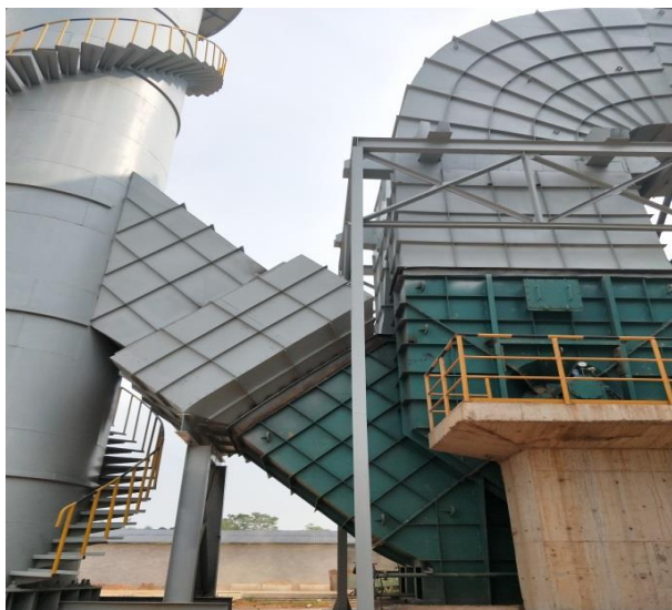
除尘器风机消声器
