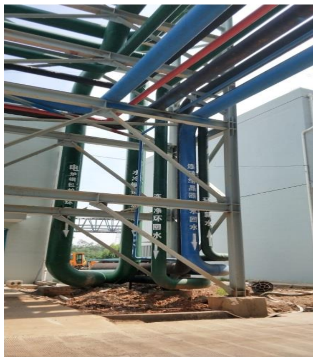
循环水管网二
