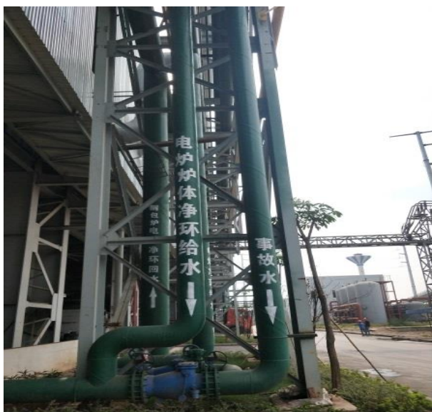
循环水管网一
