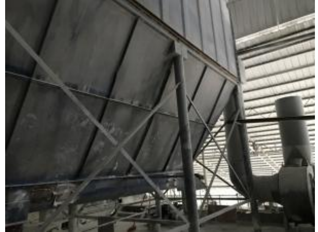
白石粉生产线包装工艺布袋除尘器+排气筒
