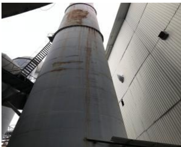
矿渣微粉生产线立磨布袋除尘器排气筒
