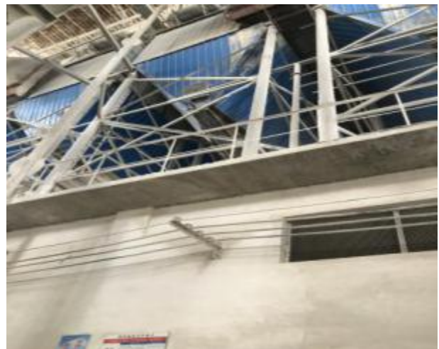
矿渣微粉生产线立磨布袋除尘器
