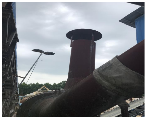
一级破碎布袋除尘器排气筒
