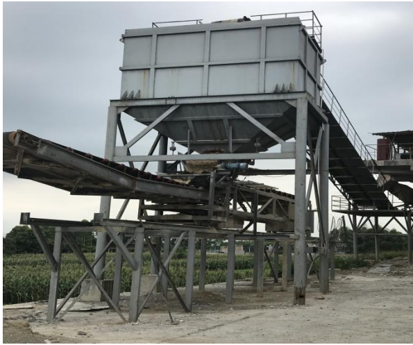
一级破碎布袋除尘器
