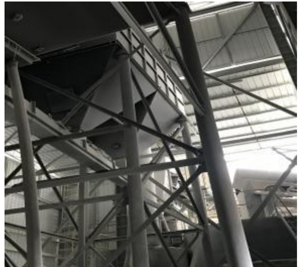
白石粉生产线立磨工艺磨头布袋除尘器
