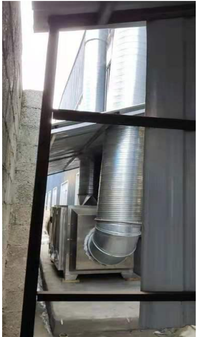
光氧+活性炭排气管（甲醛废气治理设施）
