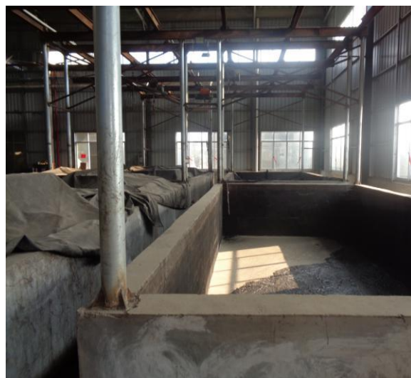
蒸煮池循环池
