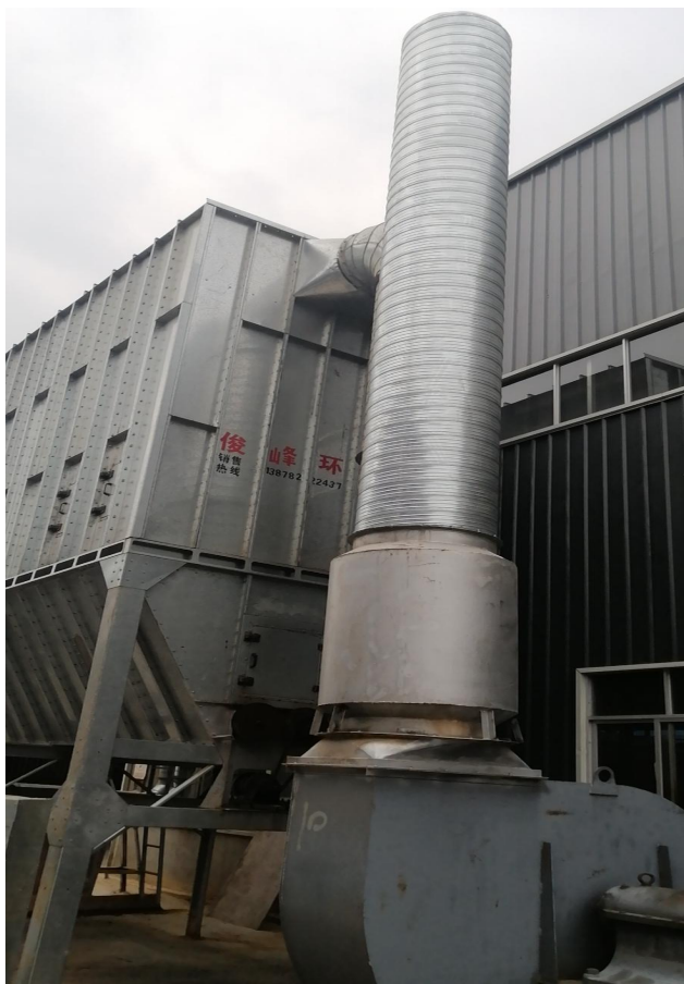
车间粉尘布袋除尘器
