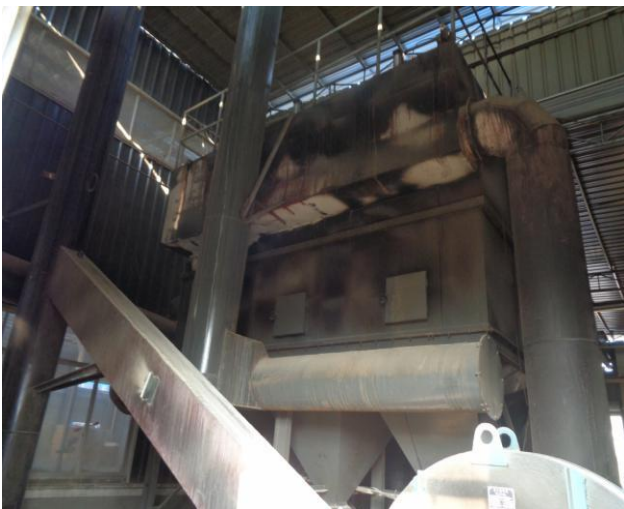
锅炉布袋除尘
