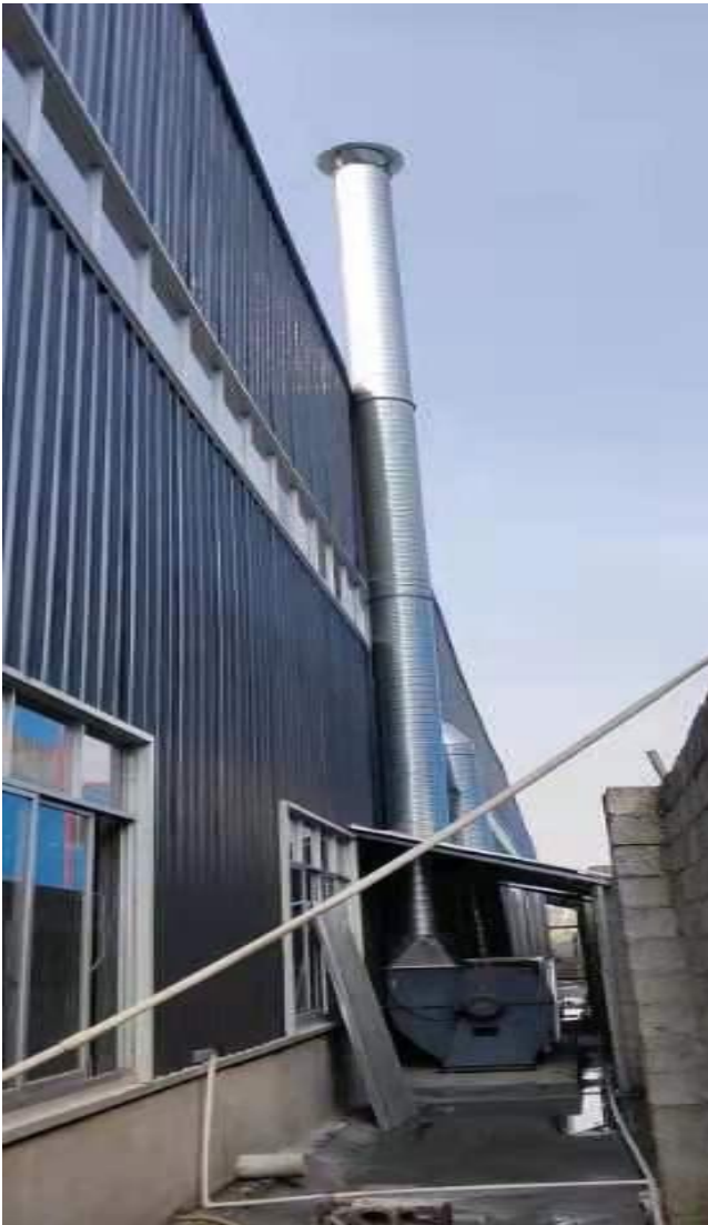
甲醛废气治理设施排气管
