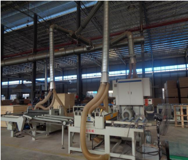
车间粉尘吸尘软管 1
