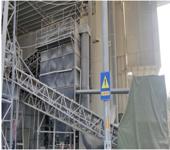
成品库皮带输送机布袋除尘器
