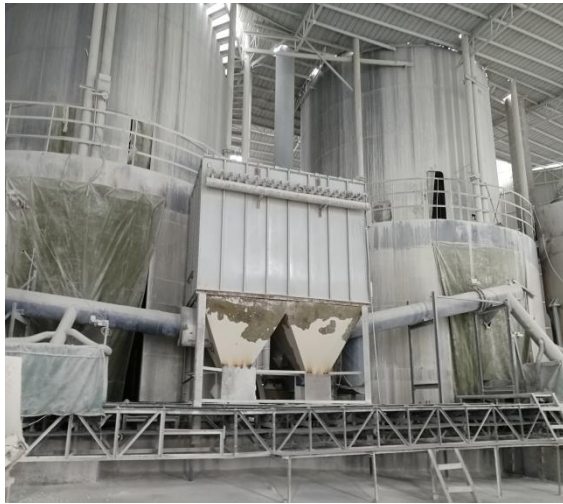
氧化钙窑下料口布袋除尘器
