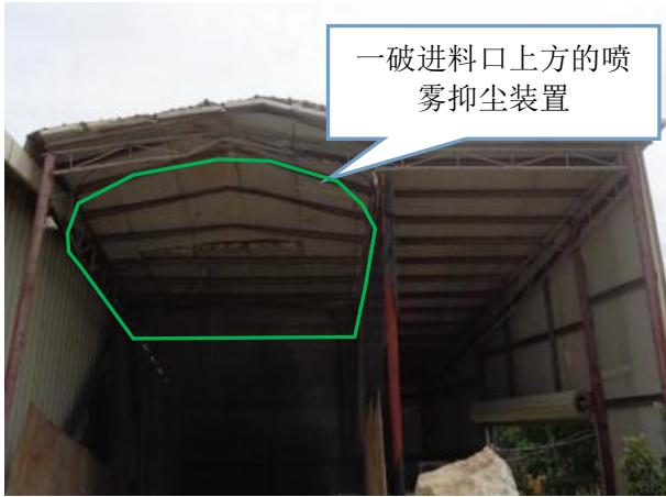
一级破碎机进口水喷淋装置
