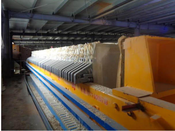
洗石废水压滤机
