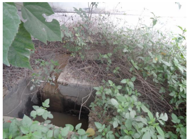
3号仓库的雨水排放口
