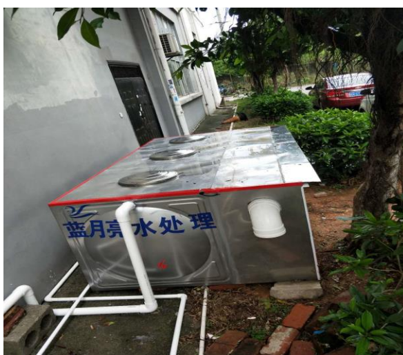
污水处理装置
