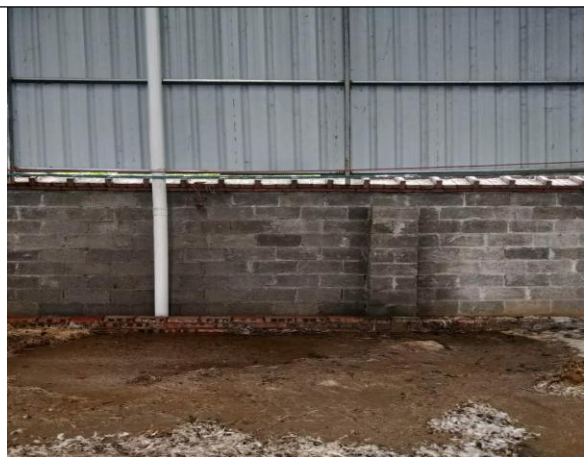
压滤污泥暂存点
