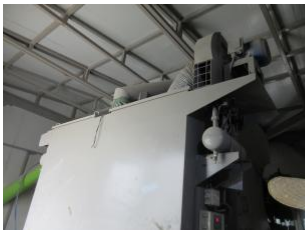
搅拌主楼内布袋除尘器
