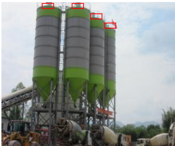
搅拌站筒仓及仓顶除尘器
