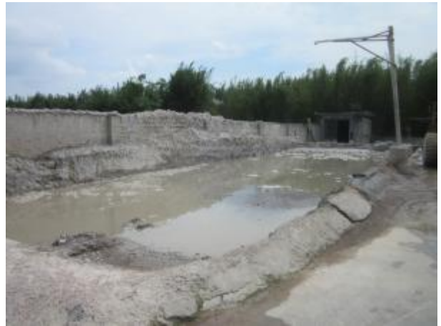
沉渣池（洗车平台）
