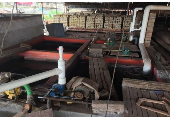
脱硫除尘循环水池
