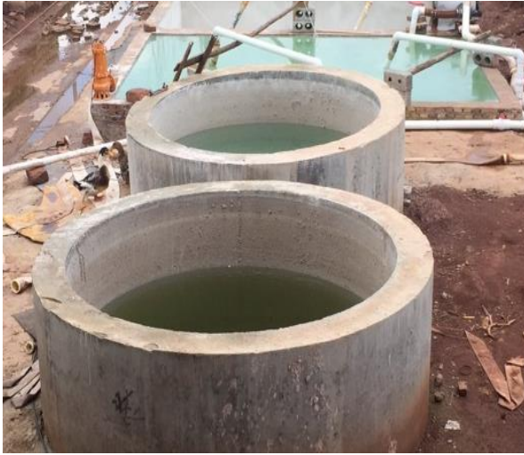
脱硫除尘循环水池
