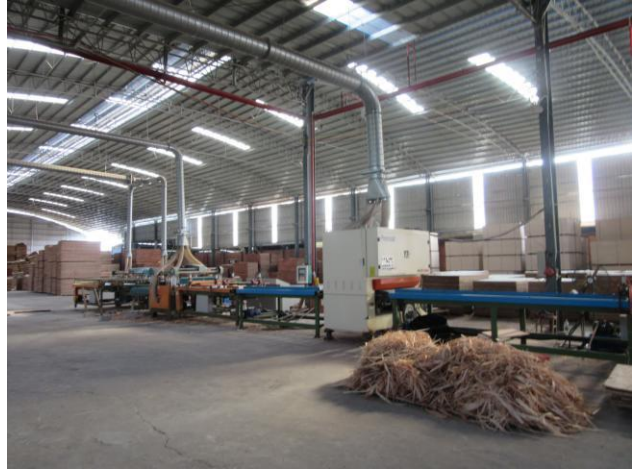
车间粉尘吸尘软管 2
