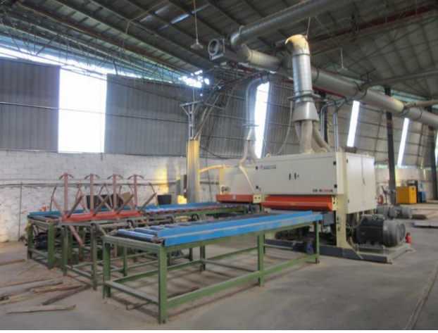
车间粉尘吸尘软管 1
