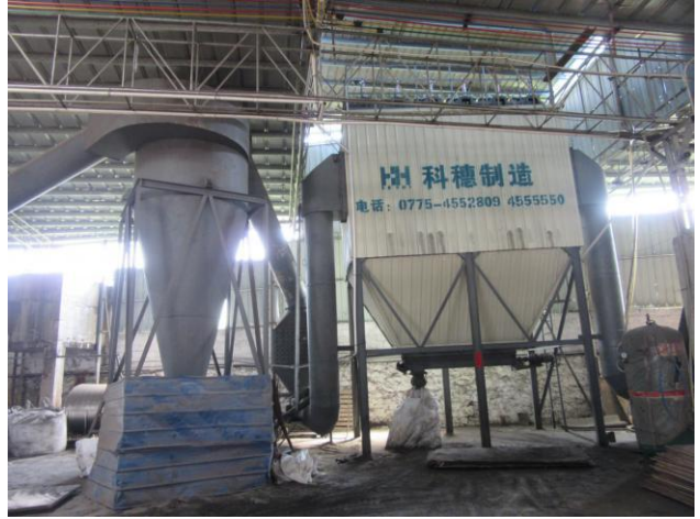
锅炉废气旋风+布袋除尘设施
