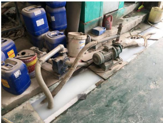
废水回抽水泵
