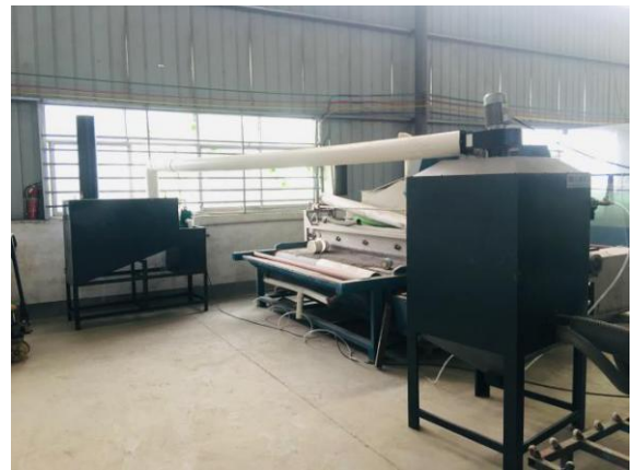
打砂机废气除尘装置（旋风+水浴）
