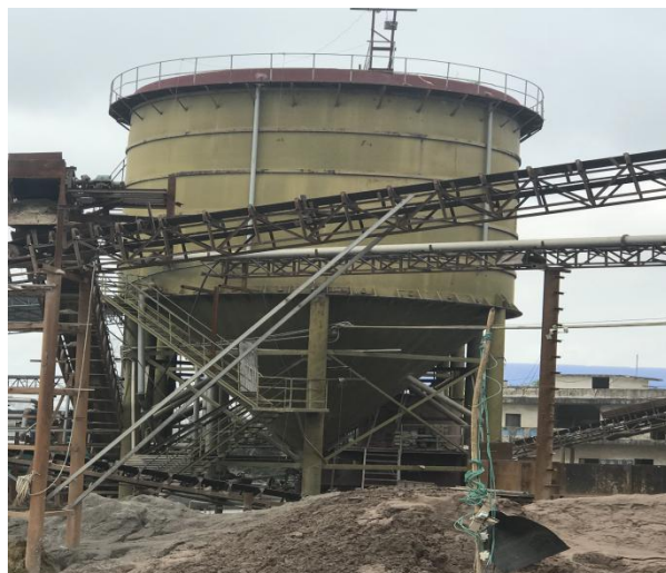
碎石生产区废水沉淀罐
