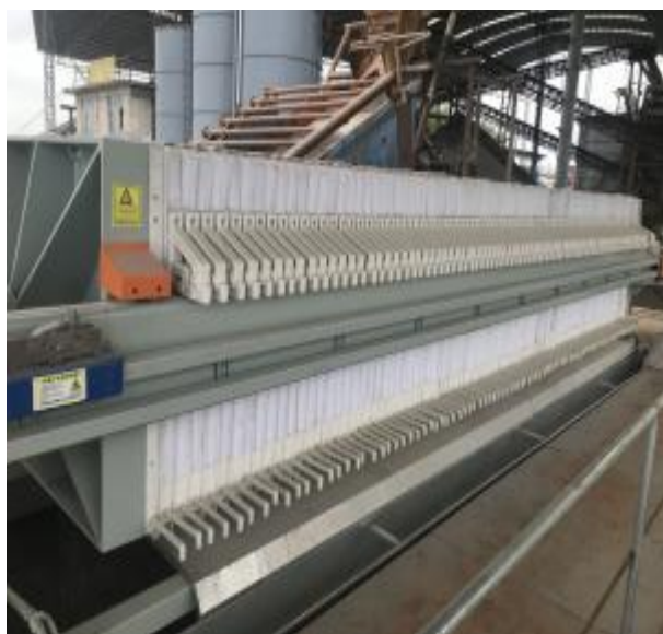
沉淀罐泥浆压滤机
