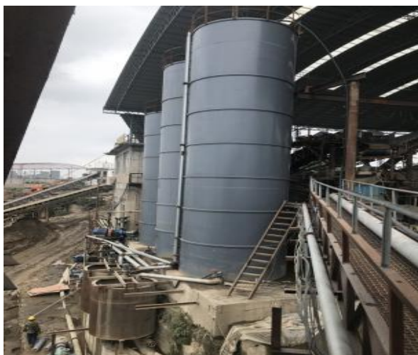
制砂生产区废水沉淀罐
