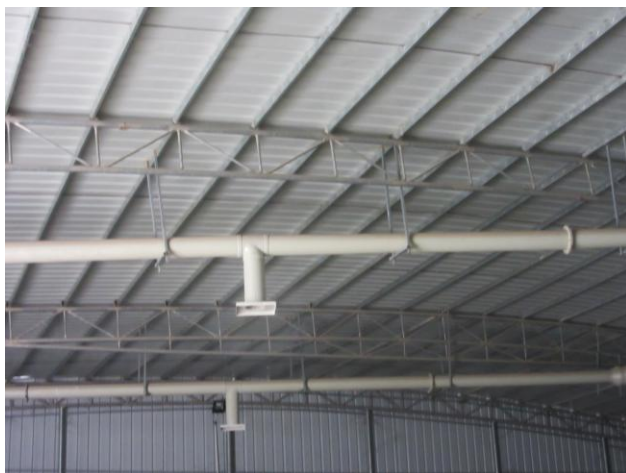
车间集气系统
