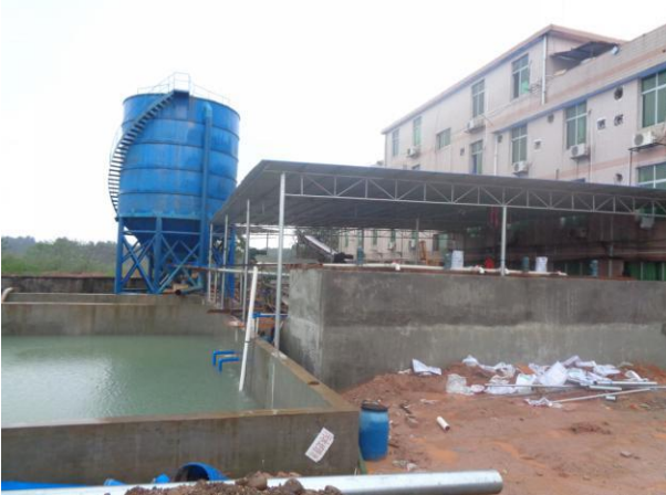
洗砂废水处理站
