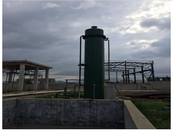
甲醛装车尾气回收塔
