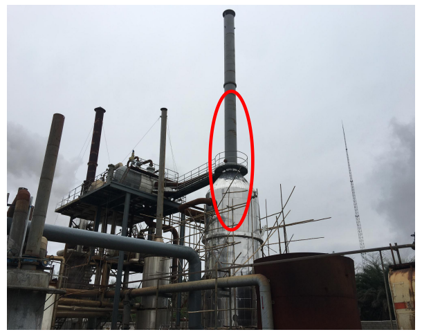
3#尾气锅炉（本次验收）
