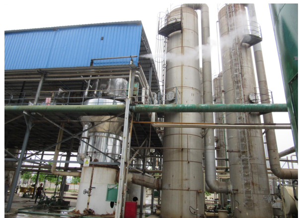
甲醛吸收塔（本次验收）
