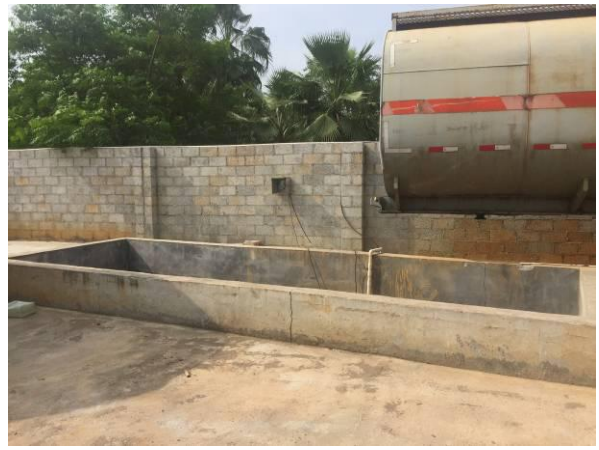
厂区初期雨水收集池
