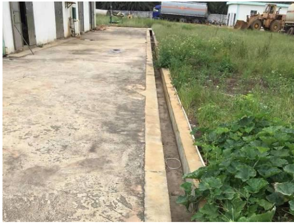
厂区雨水管网
