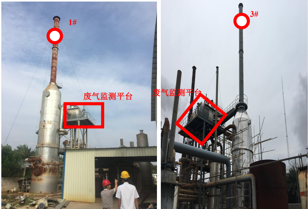
图 4-1 废气排放口及监测平台
