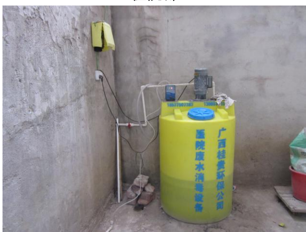
污水处理设备
