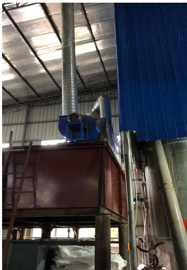
制胶废气排气筒
