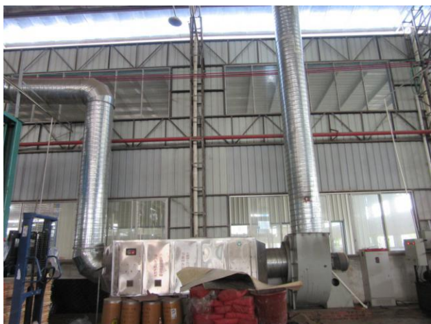
热压废气光催化氧化设备+15m 排气筒
