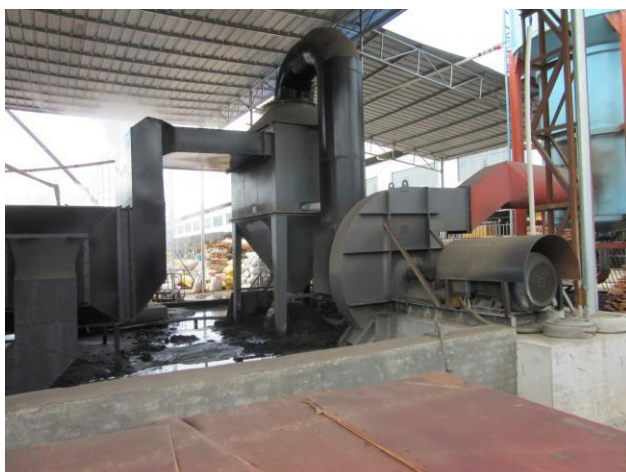
锅炉多管除尘器+湿式静电除尘器
