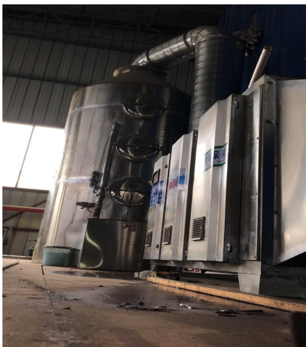
制胶废气经光催化氧化设备处理
