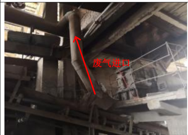
破碎、筛选粉尘抽气管道
