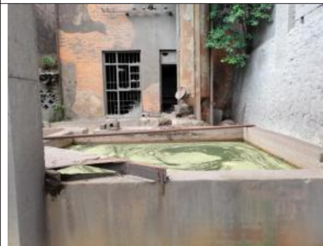
旋风喷淋废水沉淀池
