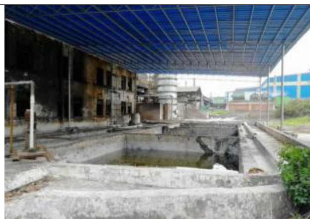
含氟废水沉淀池
