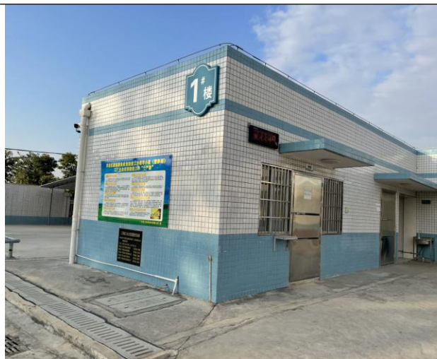
配电房及地磅房
