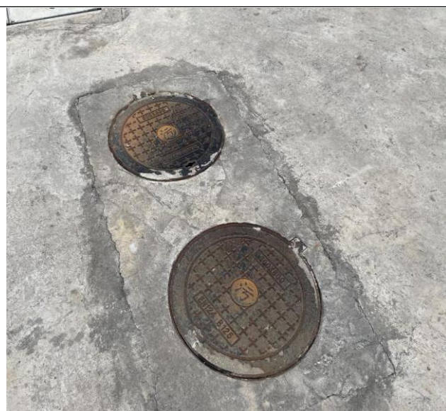
厂区污水检查井
