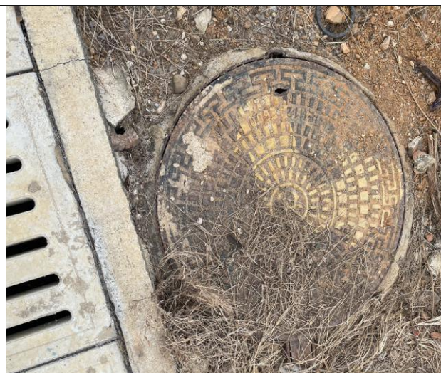
污水外排放口（消防水池东北面）
