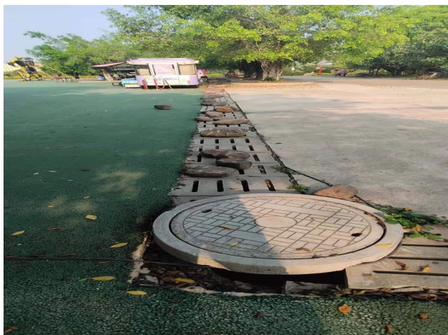
雨水收集管网
