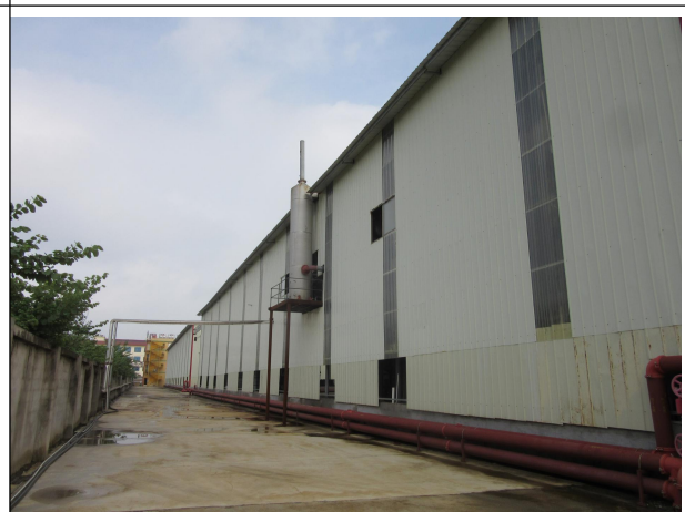
吸收塔及排气筒
