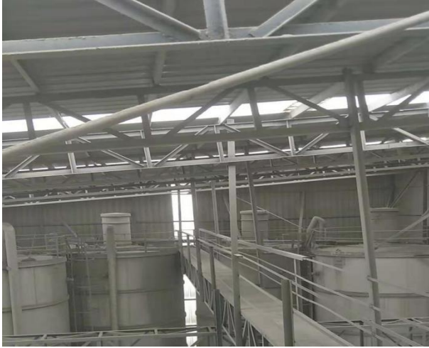
筒仓顶除尘器图 1
