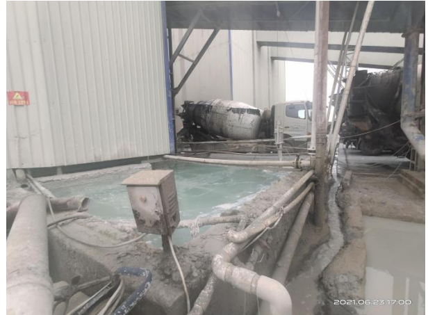
搅拌机废水沉淀池
