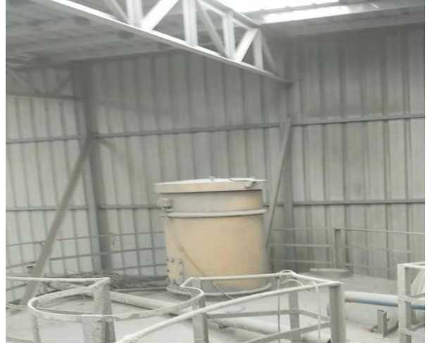
筒仓顶除尘器图 2
