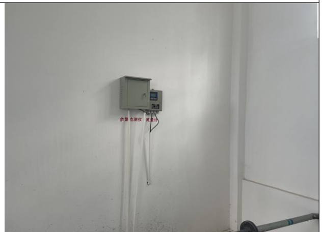
污水处理余氯检测仪、流量计
