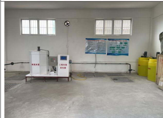
污水处理设备及地埋式池体
