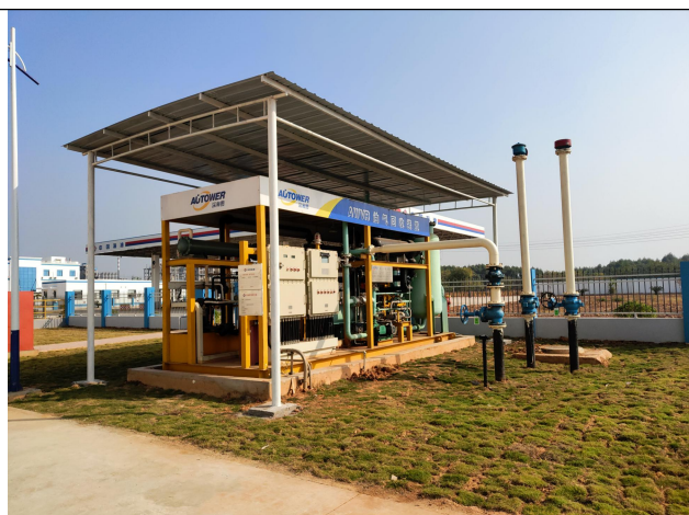
油气回收装置
