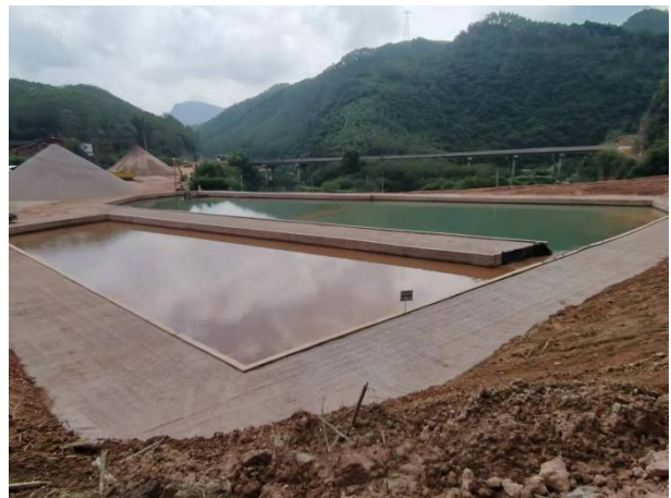
废水沉淀池及雨水沟
