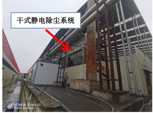
锅炉干式静电除尘系统
