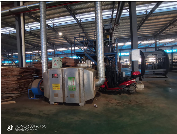
涂胶、热压-活性炭光氧一体机吸附装置
