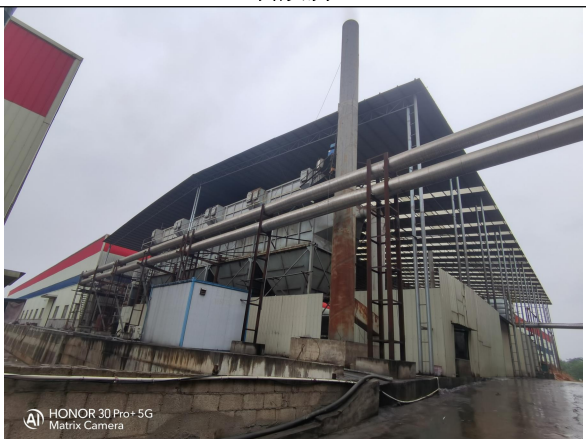
生物质锅炉废气排气筒
