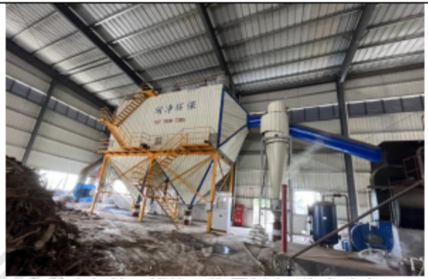
锅炉废气处理措施（旋风粉尘+静电除尘）
