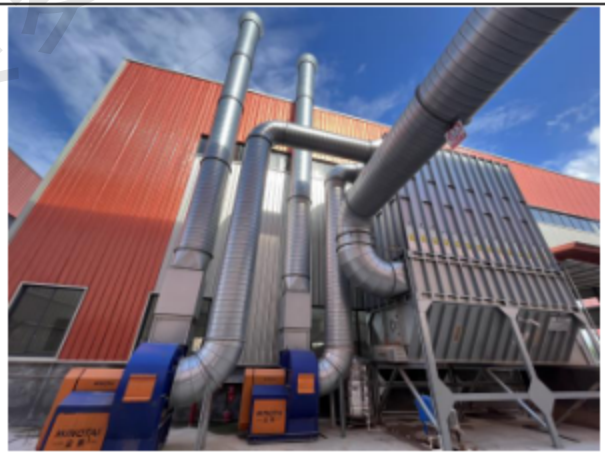
锯边粉尘布袋除尘器+排气筒（一备一用）
