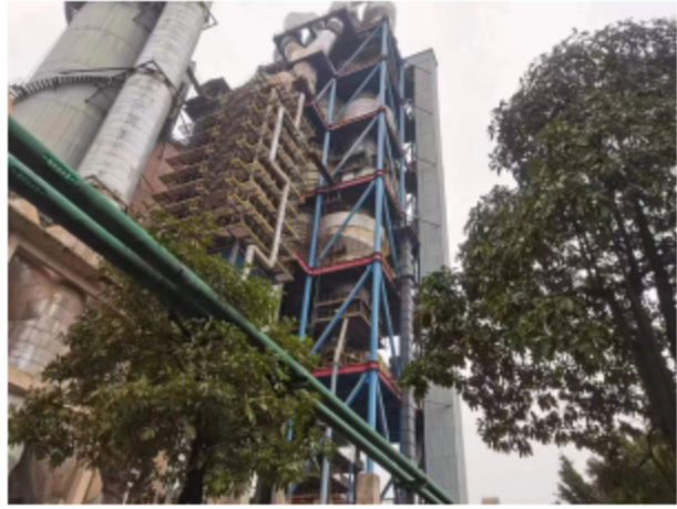
依托的窑尾废气处理设施
