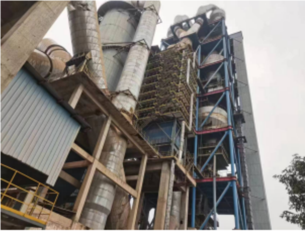
依托的窑尾废气处理设施
