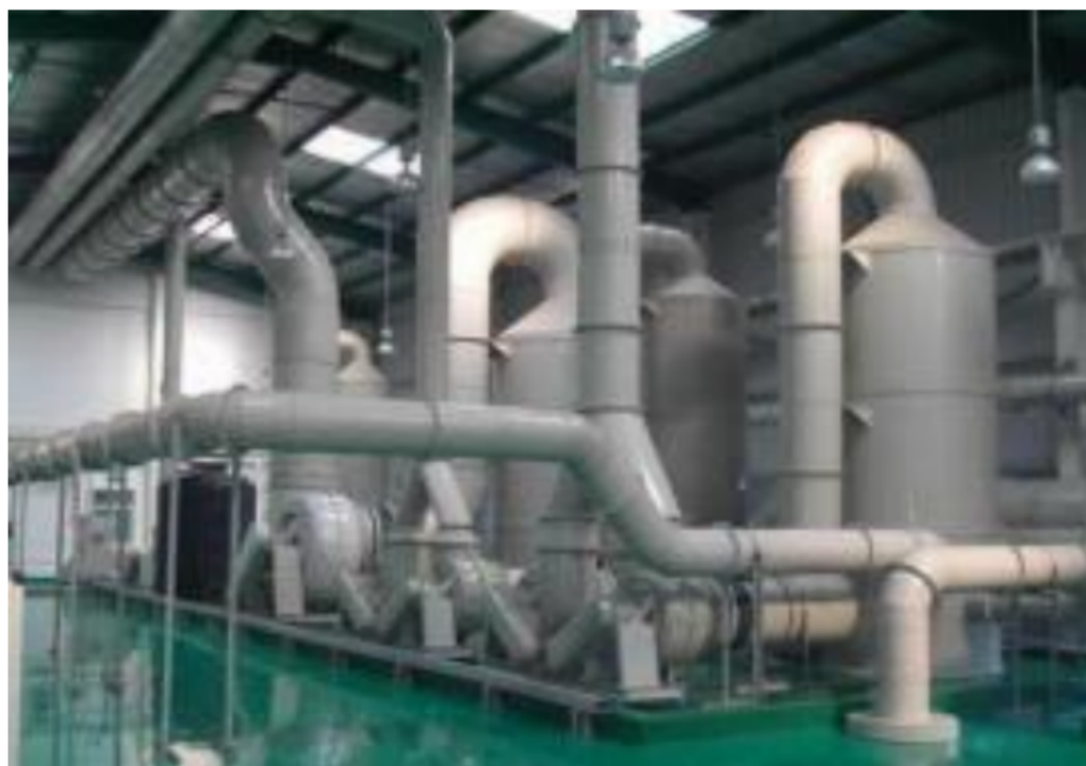
化学除臭洗涤塔
