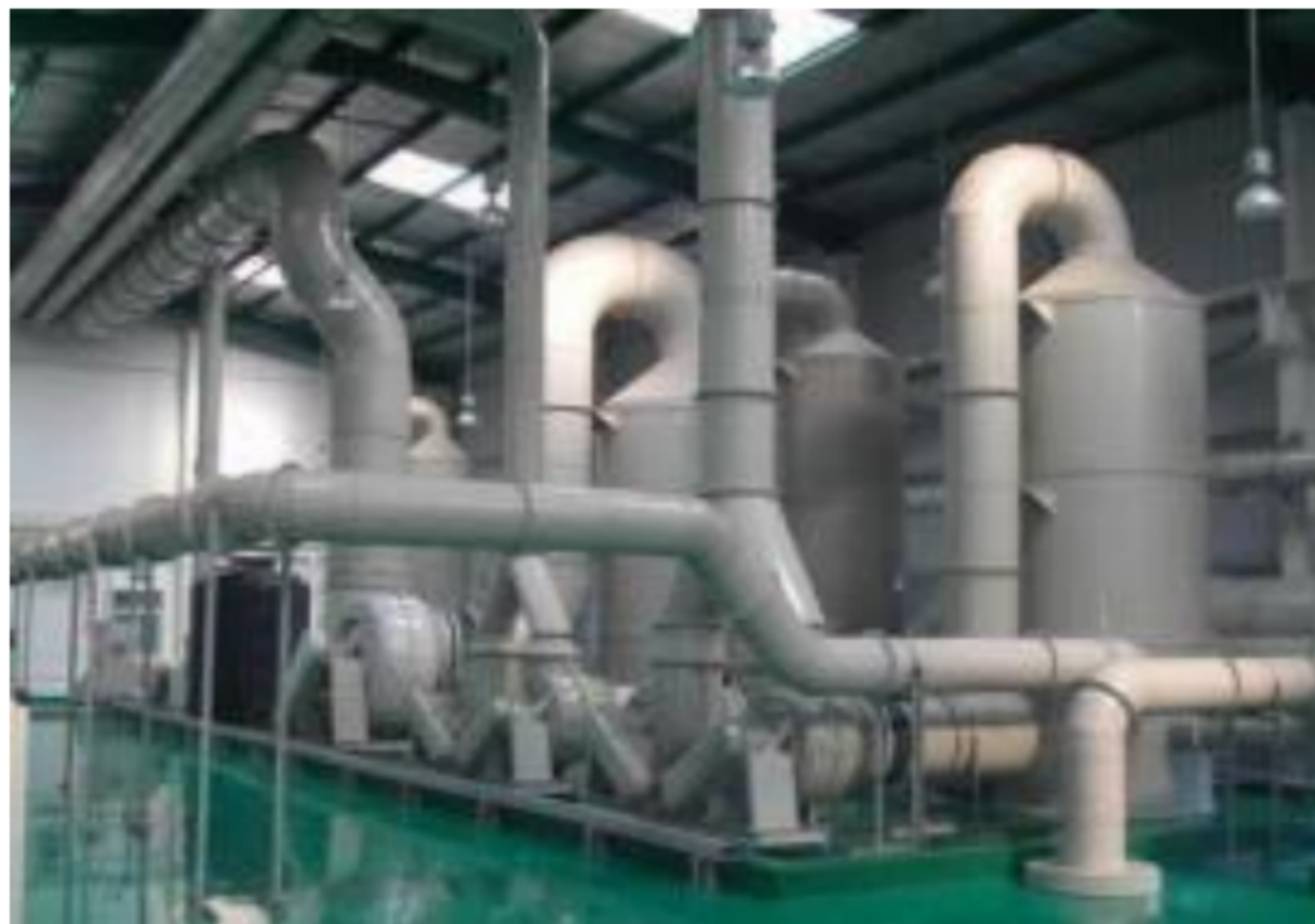
图5.2-3 化学除臭洗涤塔
