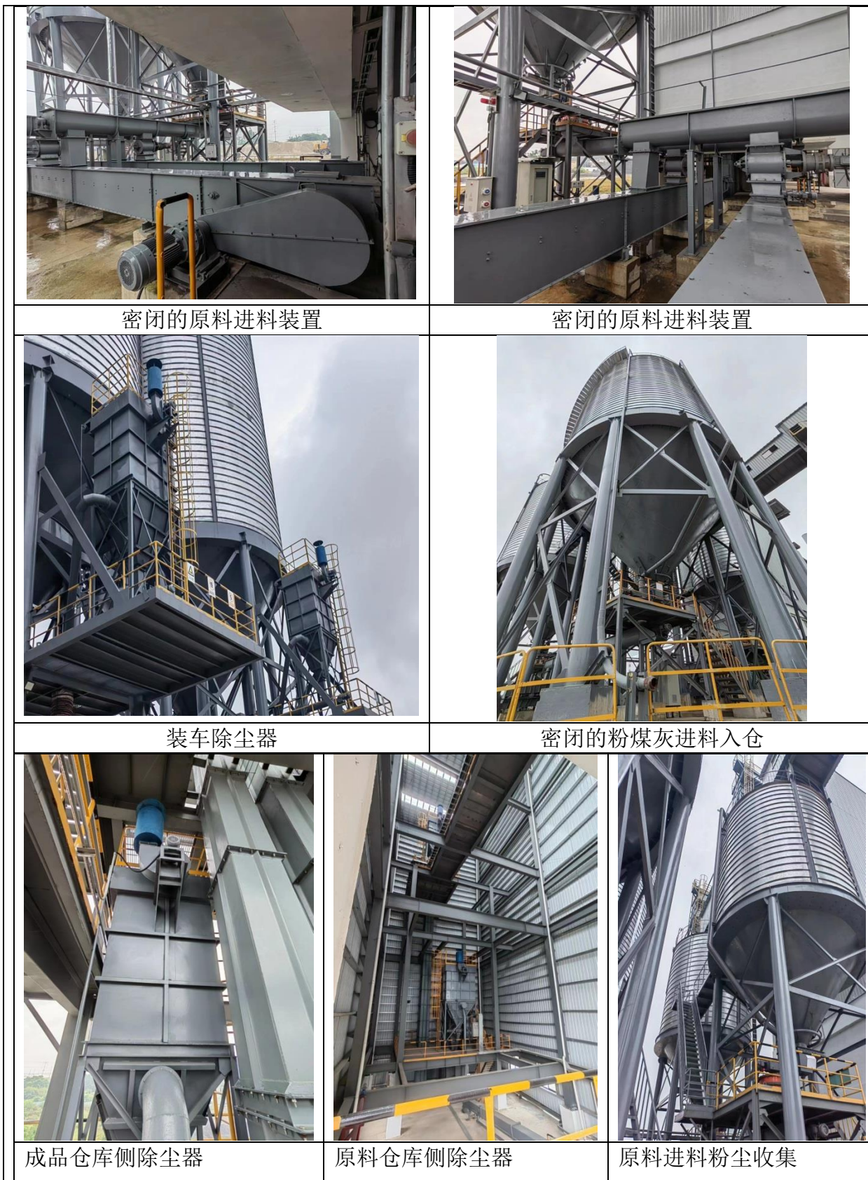
图 3-2 废气处理设施
