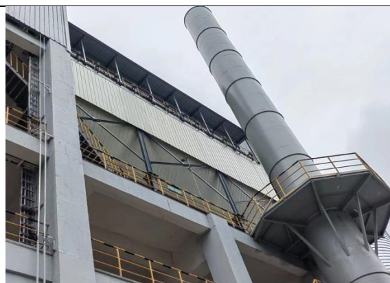
超细磨及选粉除尘器、排气筒
