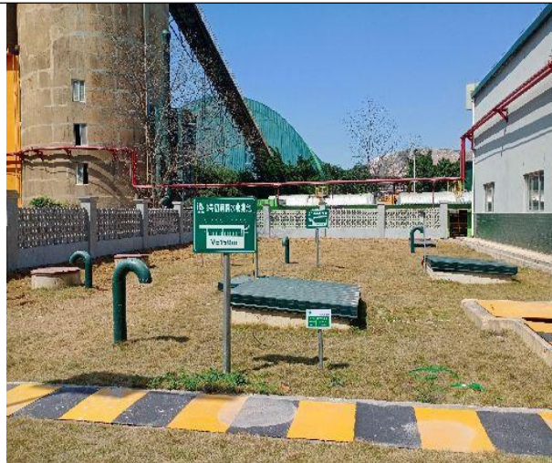
3号事故水池（埋地）
