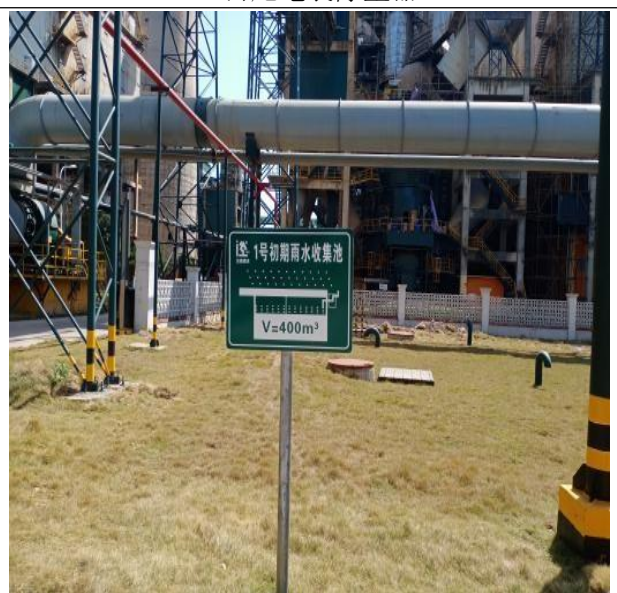
1号初期雨水收集池（埋地）
