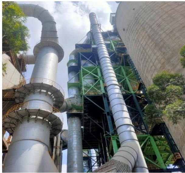
2#回转窑窑尾废气排气筒
