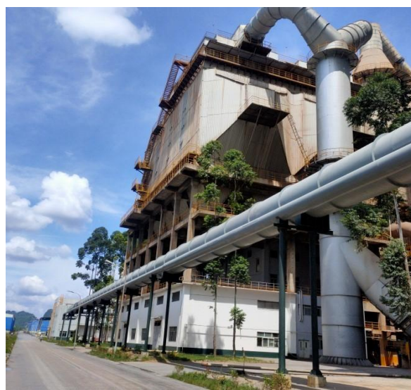
窑尾电袋除尘器
