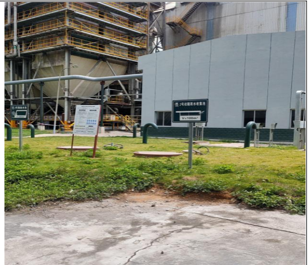
2号初期雨水收集池（埋地）
