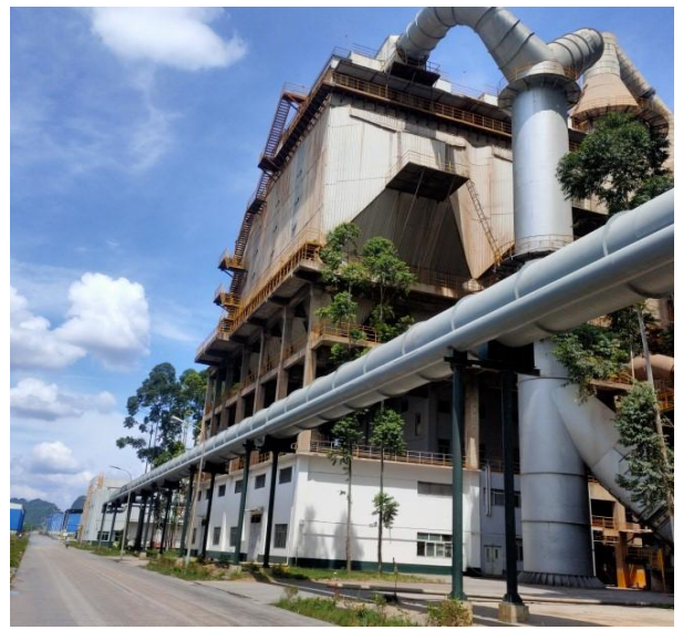
2#窑尾电袋除尘器
