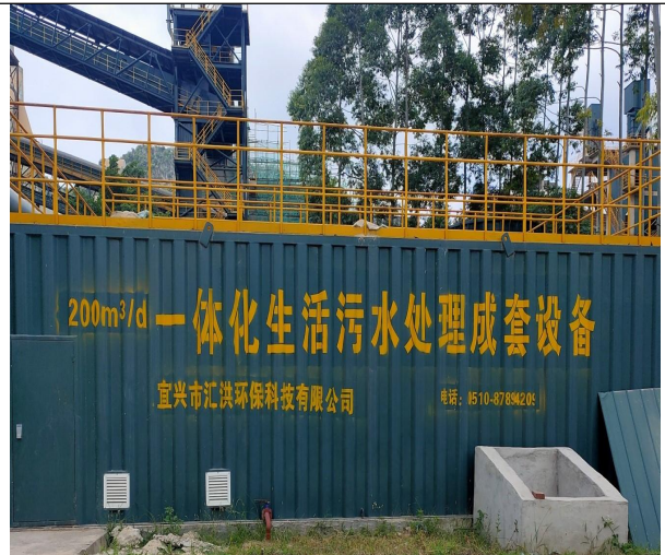
生产区一体化生活污水处理设施
