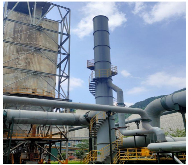
2#危废车间废气排气筒
