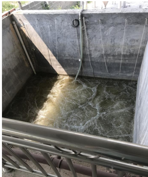
污水处理站-SBR 好氧生化池
