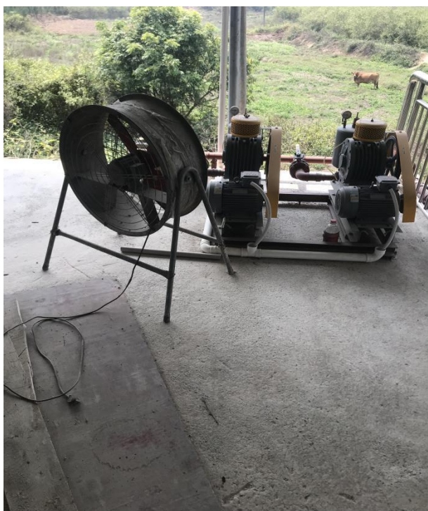
污水处理站-曝气风机
