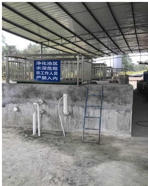
污水处理站-废水气浮池+水解酸化池（密闭加盖）
