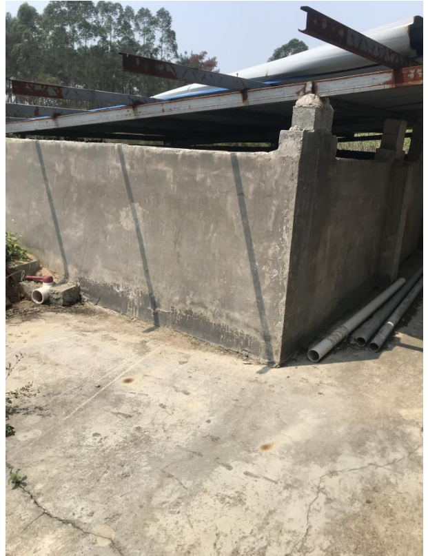
事故应急池（地面硬化）
