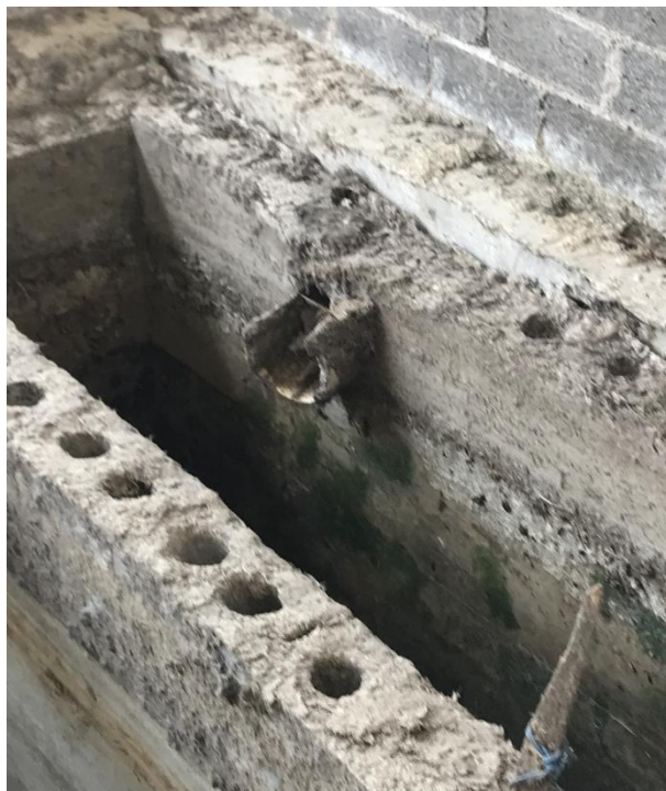
污水处理站进水口
