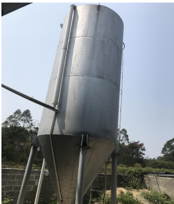
污水处理站-沉淀塔
