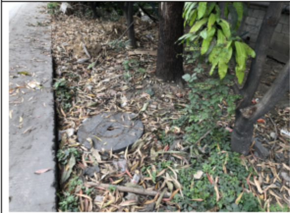
地埋三级化粪池
