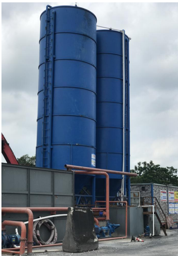
三级沉淀水罐(依托广西贵港北港国际集装箱码头有限公司处理)
