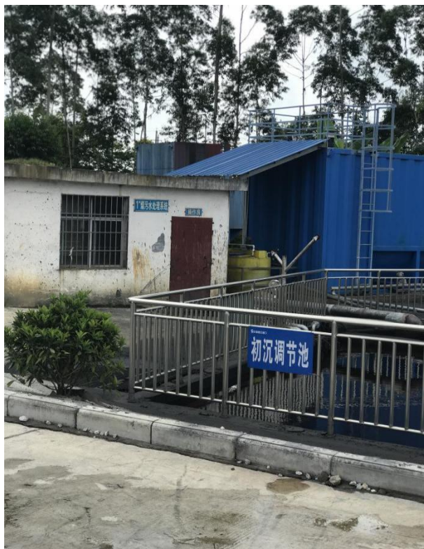
1#煤污水处理站(依托广西贵港北港国际集装箱码头有限公司处理)
