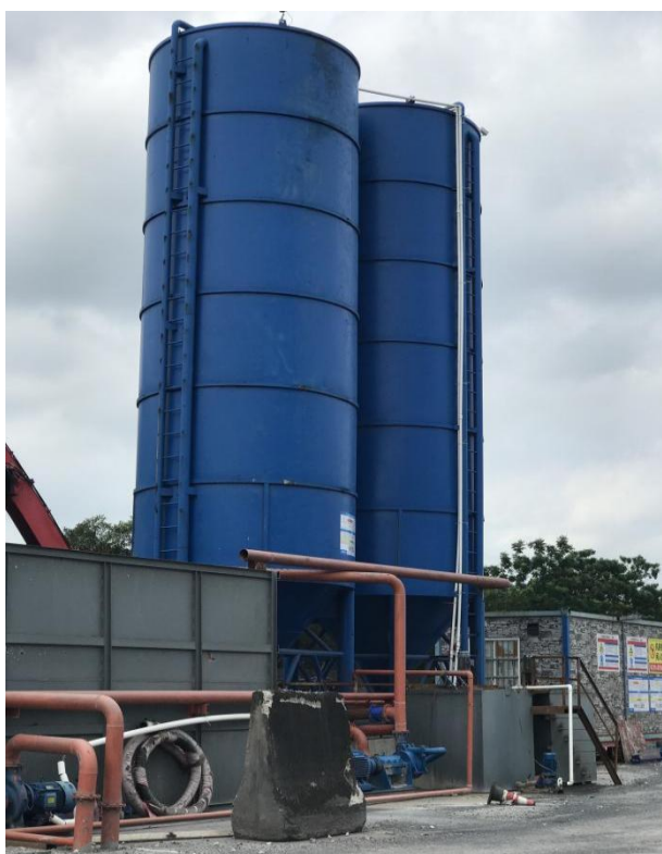
三级沉淀水罐(依托广西贵港北港国际集装箱码头有限公司处理)
